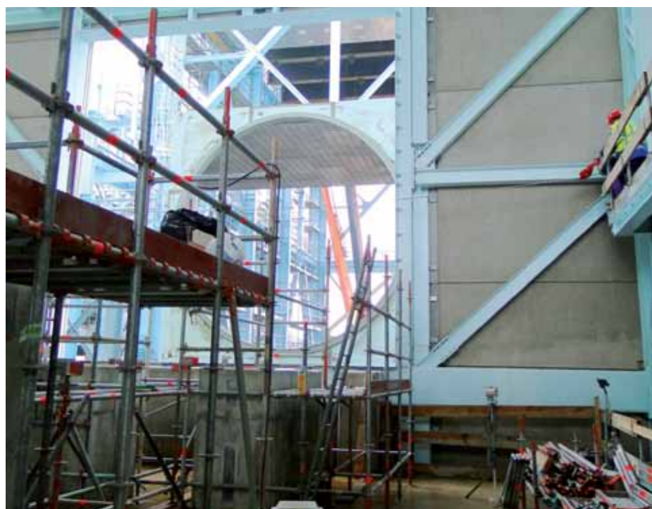
De bouw van de gasgestookte centrale ligt goed op stoom. De diffuser van de gasturbine wordt binnenkort geplaatst in de ronde opening.
