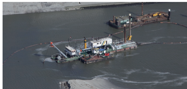
bekleed met zinkstukken en stortsteen. De geplande oplevering van de werken is voorzien in juli van dit jaar.
